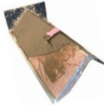
Зоб. 21: Джутові мішки, просочені глиною на опалубці та готовому елементі © Леон Ціммерманн / Інститут мистецтва, пов'язаного з архітектурою, ТУ Брауншвейг
